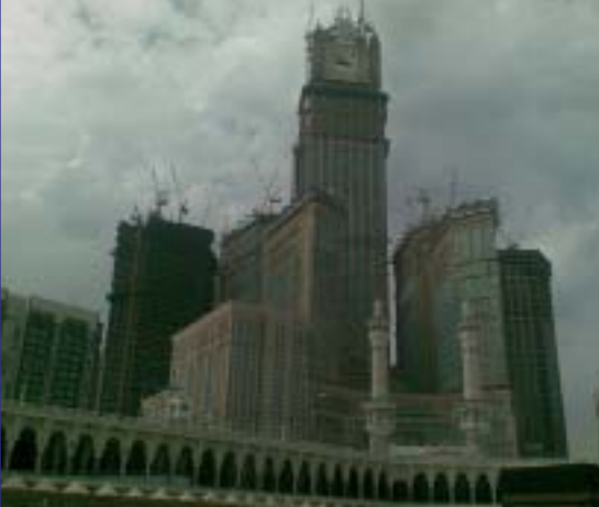
Esquerda: as torres Abraj Al Bait, sendo construídas em Mecca em 2010. A obra deve ser terminada em 2011.
